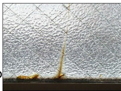
← ワイヤーが錆びてガラスが割れた写真
